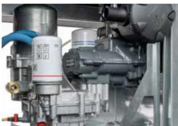
/// Filtrazione dell'olio /// Oil filtration
